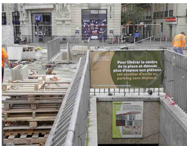
L'escalier du parking est décalé d'une dizaine de mètres.
